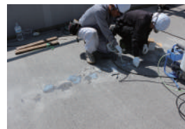
【自走式駐車場 ひび割れ】
